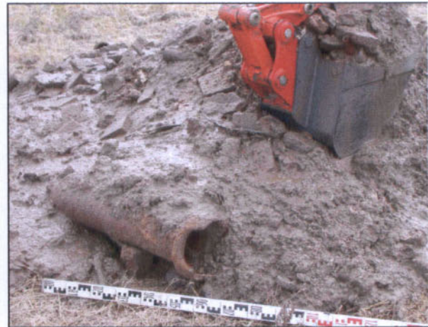
Abbildung 2: Erdaushub des Schurfs S8. Im Vordergrund der Abbildung ist ein ca. 50 cm langes Stück Steinzeugrohr zu erkennen. Hinter dem Rohr liegen gut erkennbar Reste von verschiedenen Mauersteinen.
