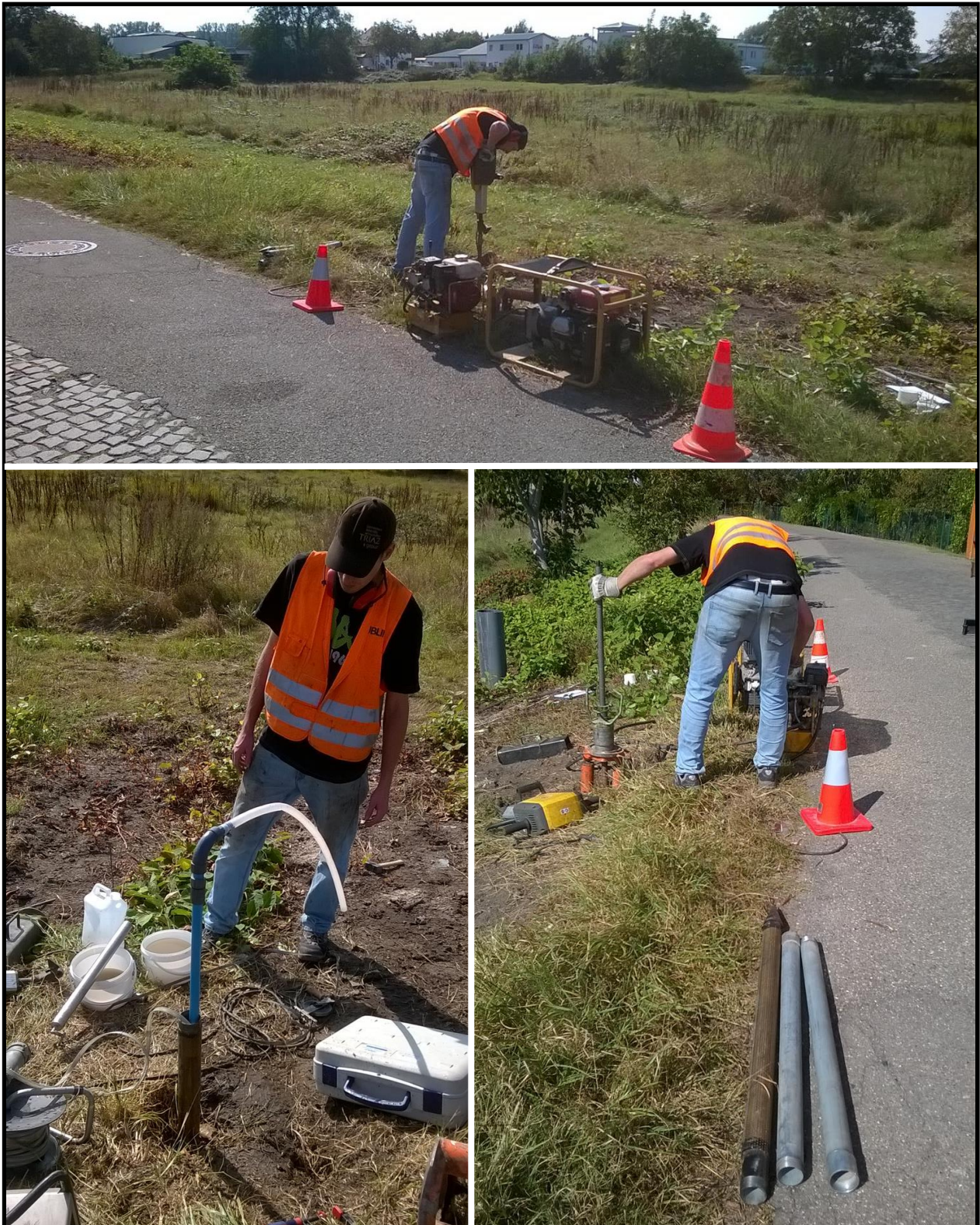
Abbildung 7: Rammkernsondierung zur Herstellung der temporären Grundwassermesstelle 2 (temp. GWM2) im Grundwasserabstrom aus Stahlrammfiltern, auf der Teilfläche der Fa. Höhl.
